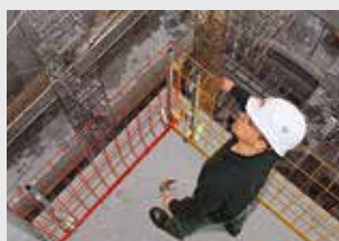
Sistemas de Seguridad
