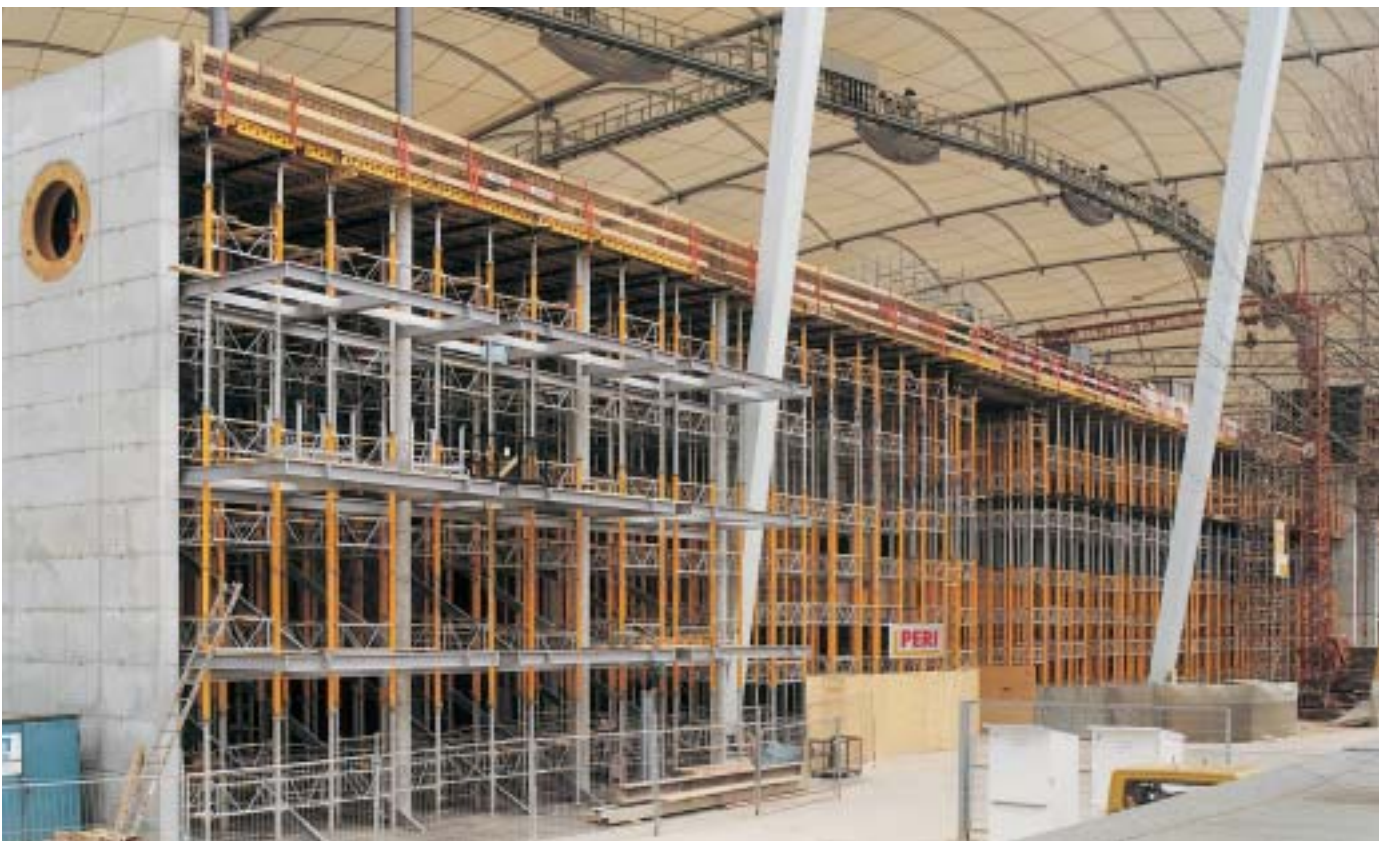
Transmisión segura de grandes esfuerzos: cimbra MULTIPROP de 14,00 m de altura sobre 3.500 m 2 de superficie.
