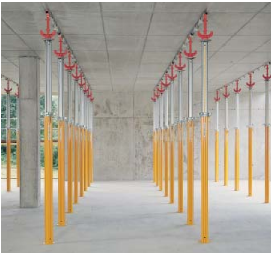
MULTIPROP 350 y encofrado para losas SKYDECK después del desencofrado. Tan sólo 0,29 puntales/m 2 de losa de hasta 40 cm de espesor.
