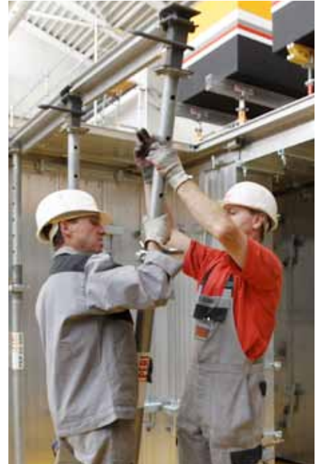
Colgar el puntal con cabezal de caída desde abajo en la viga para losa y levantarlo.
