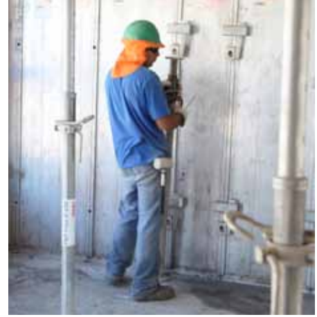
En caso de necesidad retirar el puntal en la transición de la viga para losa al panel de transición.
