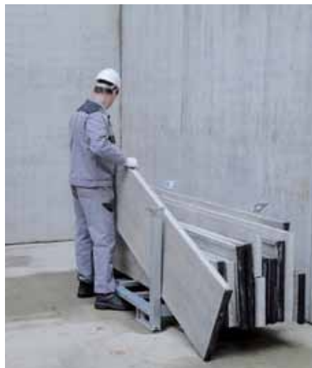
¡Los paneles deben almacenarse en pallets en posición vertical! Almacenar los accesorios en contenedores.
