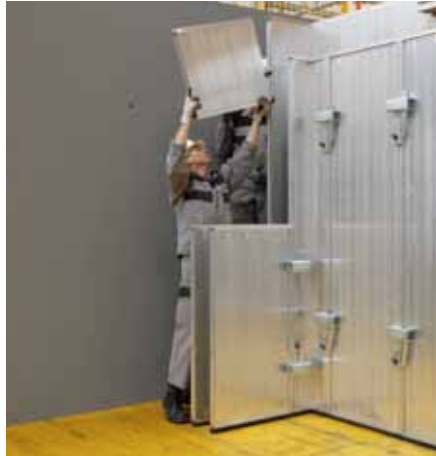
Colocar la contrarosca en el panel para muro exterior. Colocar el panel para dintel exterior.
