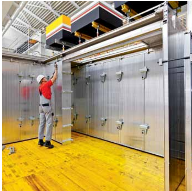
Unir encofrado lateral y paneles para muros con cerrojo para muro, losa o para atornillar, ver plano.
