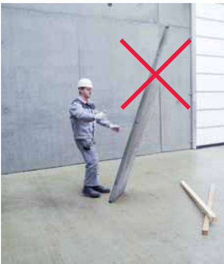
¡Los paneles no deben empujarse para hacerlos caer!
